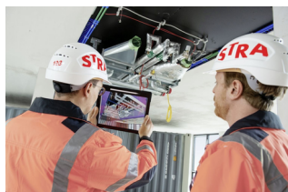
Kompetenz in Technischer Gebäudeausrüstung erweitert © STRABAG
