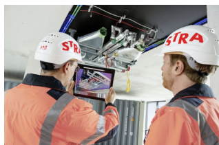
Kompetenz in Technischer Gebäudeausrüstung erweitert © STRABAG
