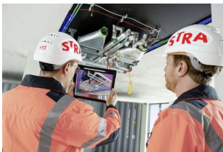
Kompetenz in Technischer Gebäudeausrüstung erweitert © STRABAG
